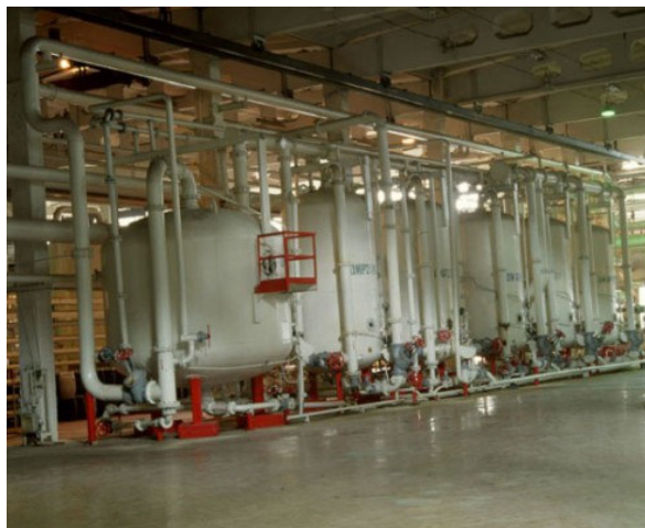
Центральний зал хімводоочищення
